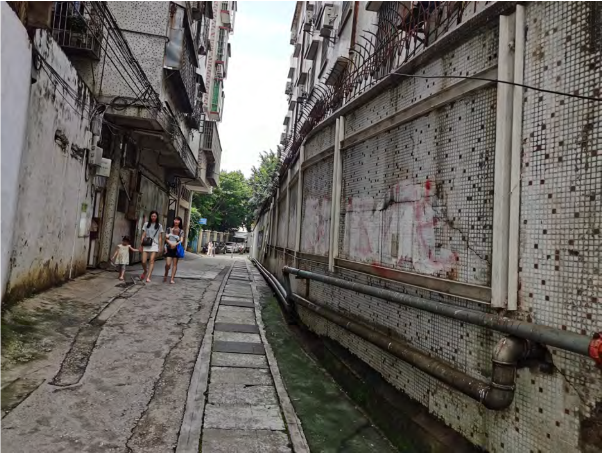
清远市妇幼保健院北院墙重砌段现状一览图
